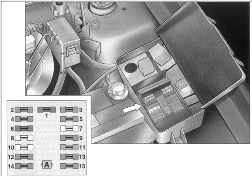
Boîtier de fusibles : 15 fusibles de protection (sous capot moteur)
