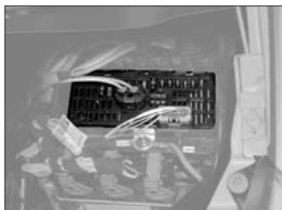
Fusibles bajo capó motor
