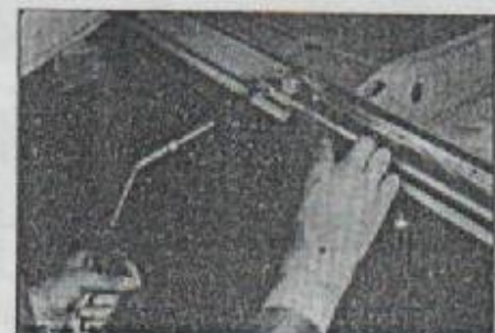
Costuras rellenas de soldadura.
