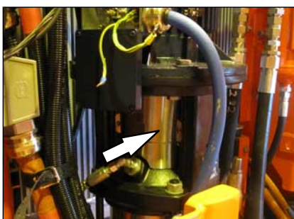
20 Cubierta del acoplamiento de la bomba de agua
