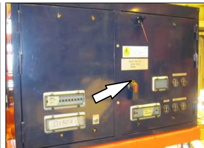
18 Puerta del armario del conmutador principal
