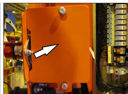
21 Cubierta del interruptor de aislamiento de la batería
