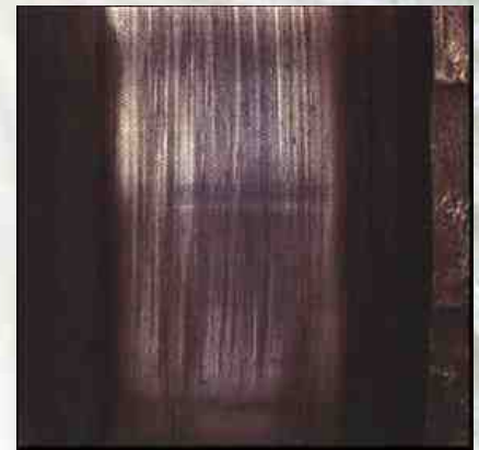
Rayaduras y desgaste de la superficie del muñón.
