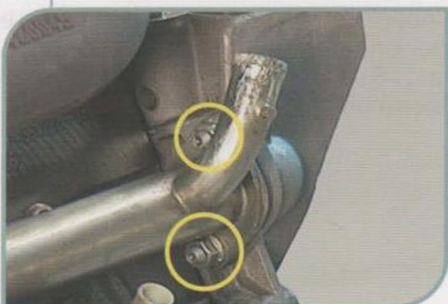
Porcas do tubo rígido de saída da bomba
