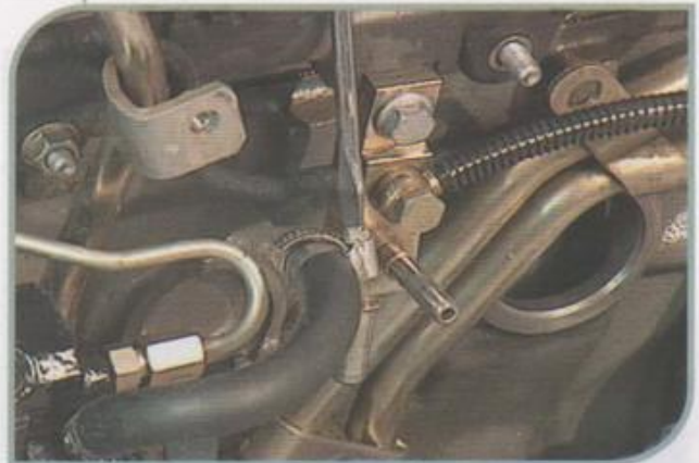
Mangueira de retorno de combustível da bomba
