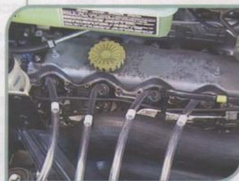
Mangueiras instaladas nos bicos
