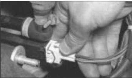
Y Los enchufes del cableado pueden causar problemas si están sucios o no están conectados correctamente.
