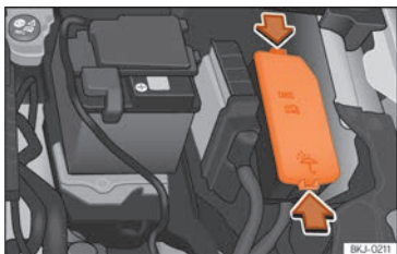
Fig. 64 En el vano motor: tapa de la caja de fusibles.
